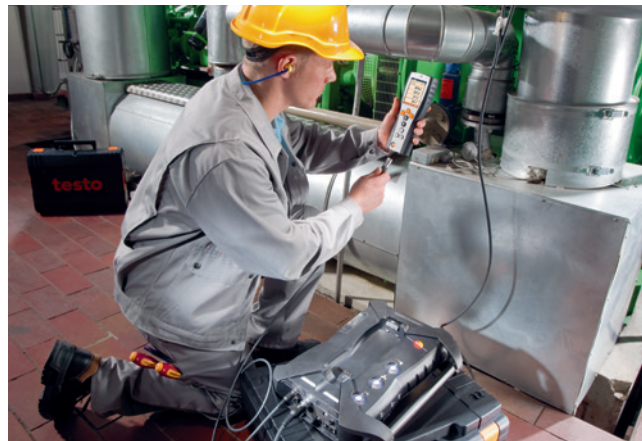
Vorbereitung einer Kontrollmessung an einem Blockheizkraftwerk mit dem testo 350.
