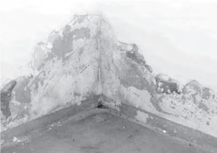
Fig. 25: Ejemplo de daño por humedad
