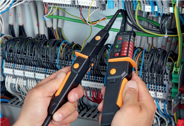
Bir şalter kabini içinde voltajın ölçülmesi.
