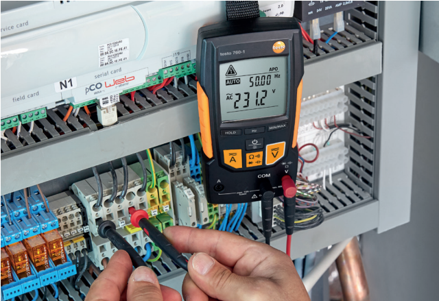
Bir ısı pompasının şalter kutusundaki voltajın test edilmesi.
