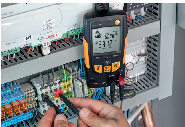
Feszültségvizsgálat egy hőszivattyú kapcsolószekrényén.
