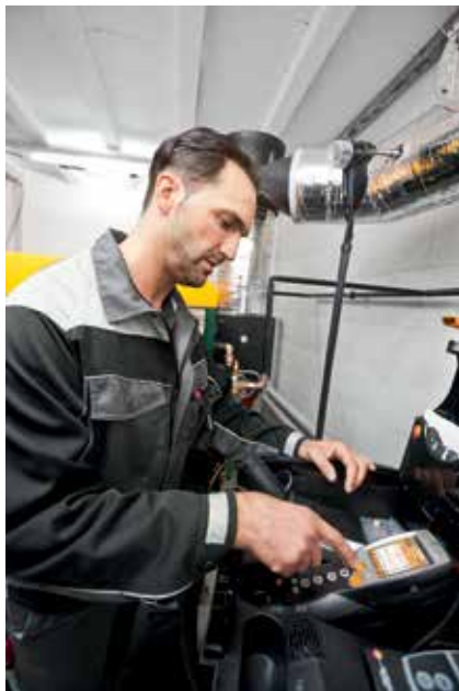
Fig. 23: medición de partículas finas en sistemas de calefacción de combustibles sólidos
