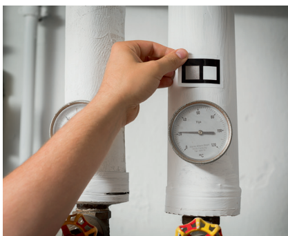
Pegue el testo \epsilon -marker y capte el objeto con la cámara digital de la cámara termográfica.
