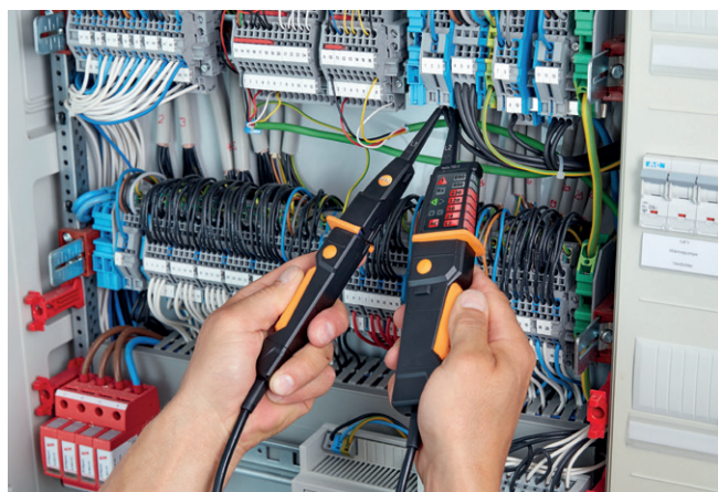
Măsurarea tensiunii într-un tablou electric.
