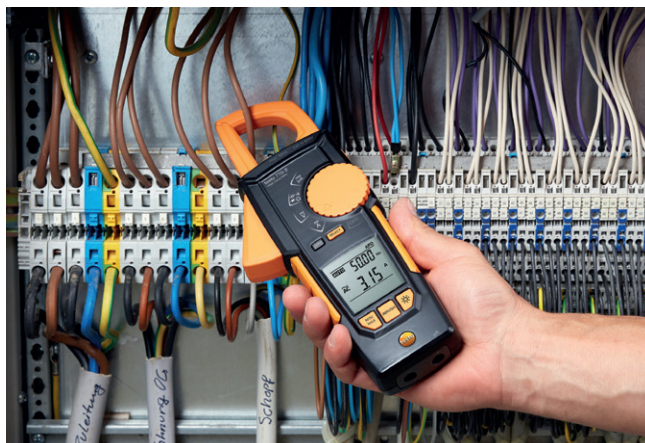
Măsurarea curentului într-un tablou electric.
