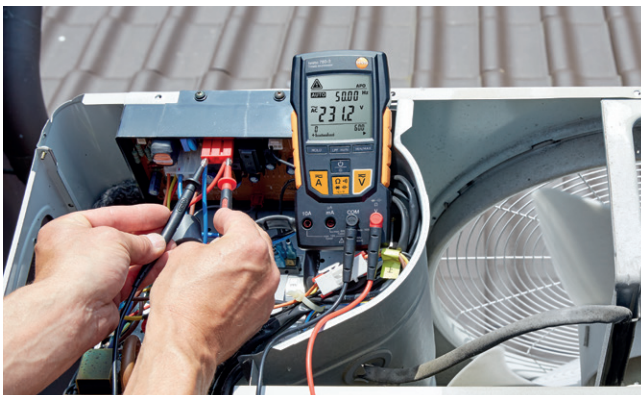
Măsurarea tensiunii pe o unitate de refrigerare exterioară cu testo 760 .
