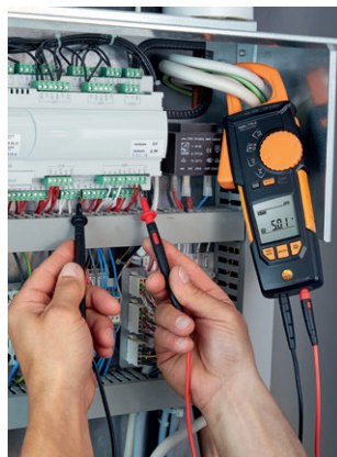
Măsurarea tensiunii în panoul de control al unei pompe de căldură cu instrumentul de măsurare suspendat.
