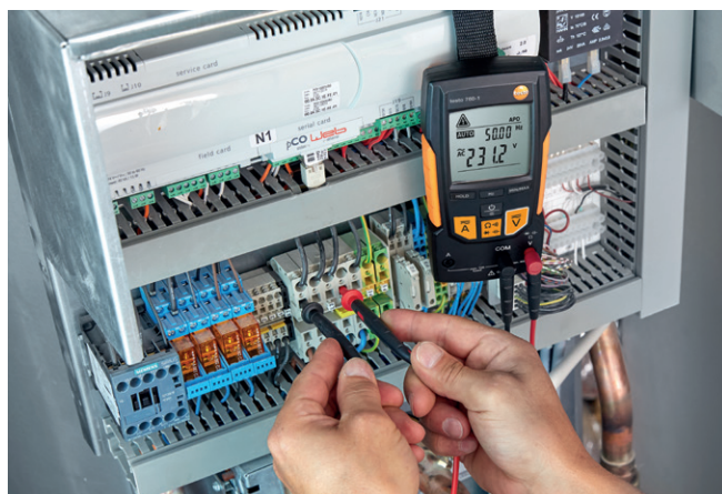
Testarea tensiunii în tabloul de comandă al unei pompe de căldură.
