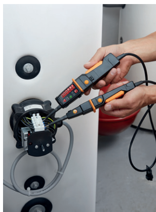
Măsurarea tensiunii la un boiler.
