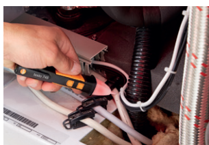
Verificare preliminară pe un compresor
