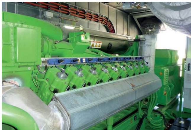
稼働中の2Gコージェネレーションシステム
