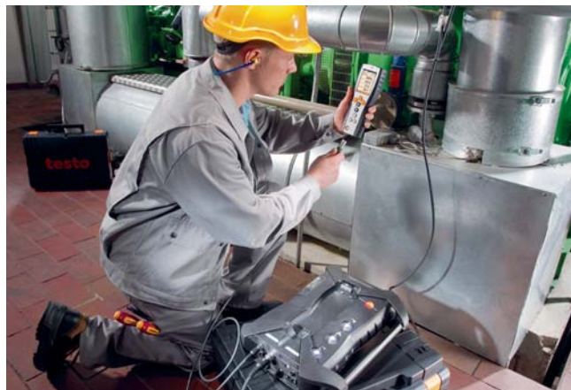
testo 350を使用した火力発電プラントの制御測定の前準備
