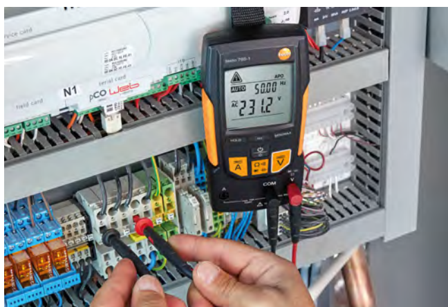
Testování napětí v rozvaděči tepelného čerpadla.
