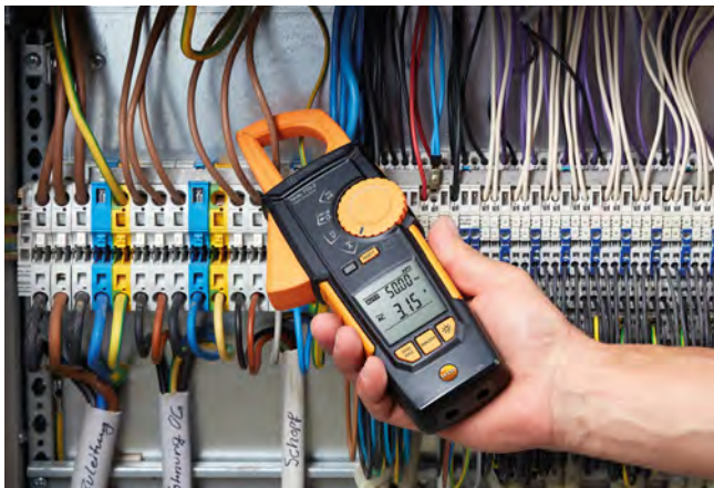
Měření proudu v rozvaděči.
