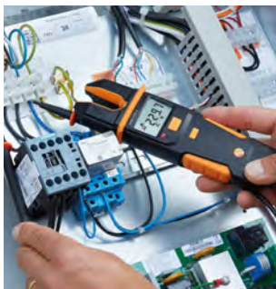
Měření napětí na kompresoru.
