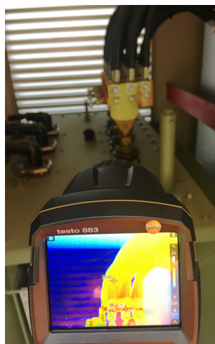
Figura 2: Imagine termografică a conexiunii unui transformator (de la 20.000 volți la 400 volți) printr-un cablu de joasă tensiune.
