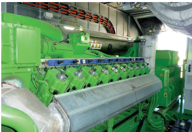
O centrală termică și electrică combinată 2G în funcțiune.
