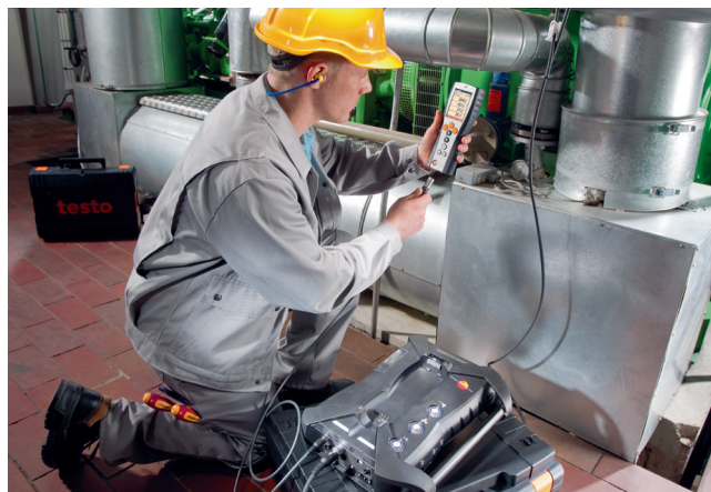
Pregătirea pentru o măsurare de control la o centrală termică și electrică combinată cu testo 350.
