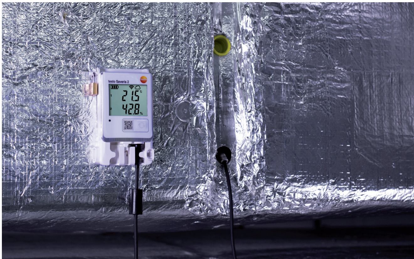
Uma sonda testo Saveris 2 WiFi mede a temperatura e a humidade num duto de ventilação.
