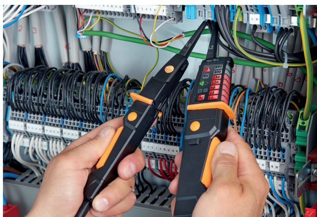
Pomiar napięcia w szafach sterowniczych.
