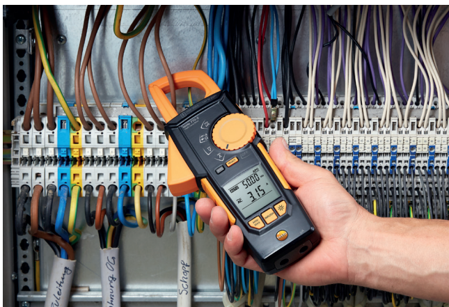
Pomiar prądu w szafach sterowniczych.
