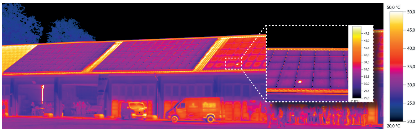
Imágenes panorámicas de instalaciones fotovoltaicas y análisis de detalles con teleobjetivo.
