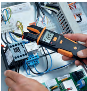
Medición de tensión en un compresor.
