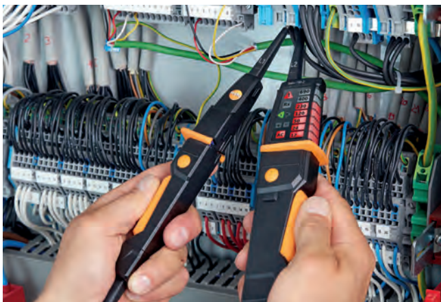
Medición de tensión en el armario de distribución.
