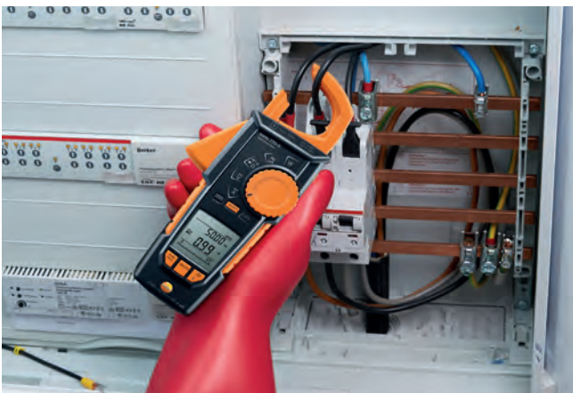
Medición de corriente en un armario de distribución.
