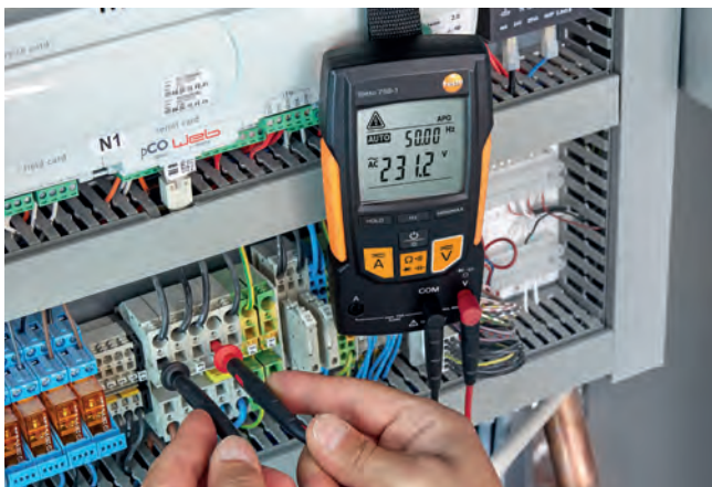
Medición de tensión en el panel de conexiones de una bomba de calor.
