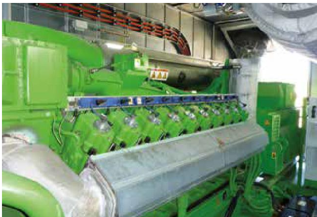
Instalacja kogeneracyjna firmy 2G Energy podczas pracy.
