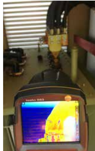
変圧器 (20,000 ボルト→400 ボルト)を低圧ケーブルで接続したときの熱画像
