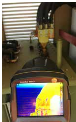
Figura 2: Immagine termografica del collegamento di un trasformatore (da 20.000 volt a 400 volt) con un cavo a bassa tensione.
