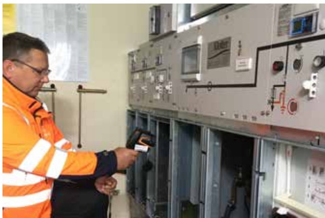
Figura 1: Misura termografica su un impianto di commutazione a media tensione.
