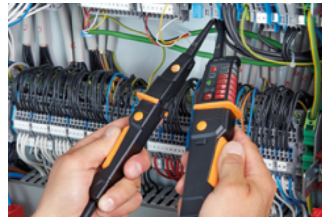
Misura della tensione su un quadro elettrico.
