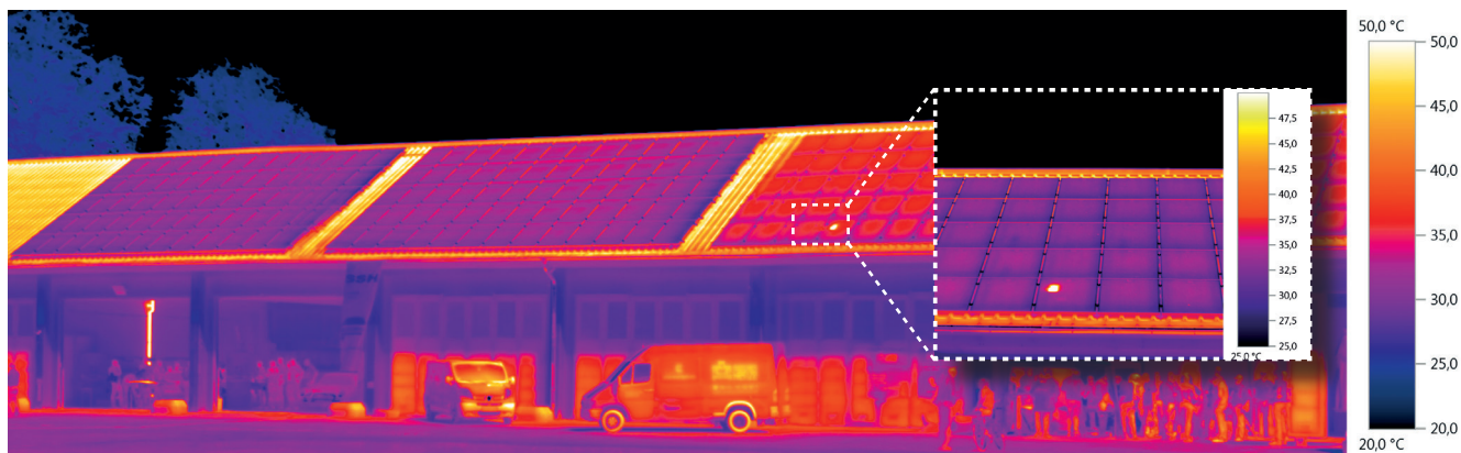
Panoramatický snímek fotovoltaického zařízení a podrobná analýza teleobjektivem.
