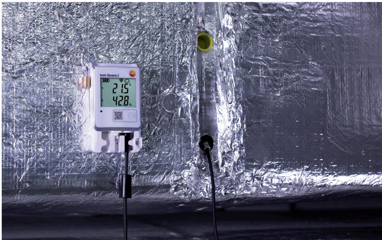
Sonda testo Saveris 2 WiFi měří teplotu a vlhkost v potrubí ventilace.
