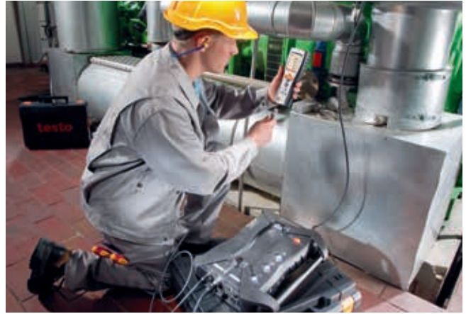
使用testo 350对一台热电联产设备进行控制测量前的准备工作
