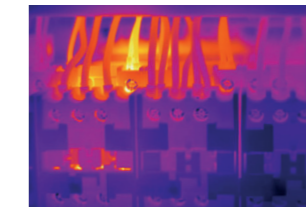
Anlagen instand halten: Zu hohe Temperaturen an Sicherungen und elektrischen Bauteilen erkennen bevor es zu Ausfällen kommt.
