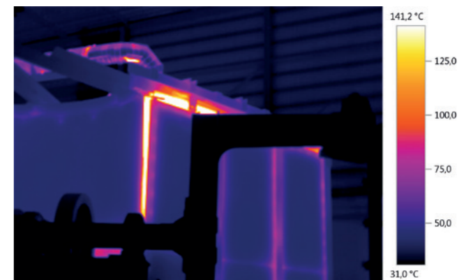
Industrieofen mit fehlerhafter Isolierung.
