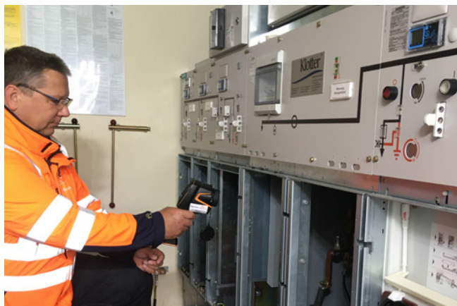
Afbeelding 1: Thermografische meting bij een middenspannings-schakelsysteem.
