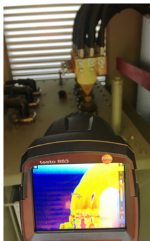
Afbeelding 2: Thermografische opname van de koppeling van een transformator (20.000 volt naar 400 volt) via laagspanningskabel.
