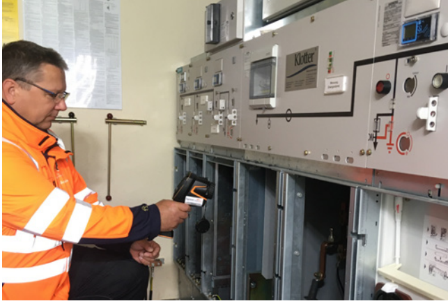
Figura 1: Medición de termografía en una celda de media tensión.
