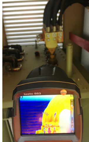
Figura 2: Captura termográfica de la conexión de un transformador (20.000 voltios a 400 voltios) mediante un cable de baja tensión.
