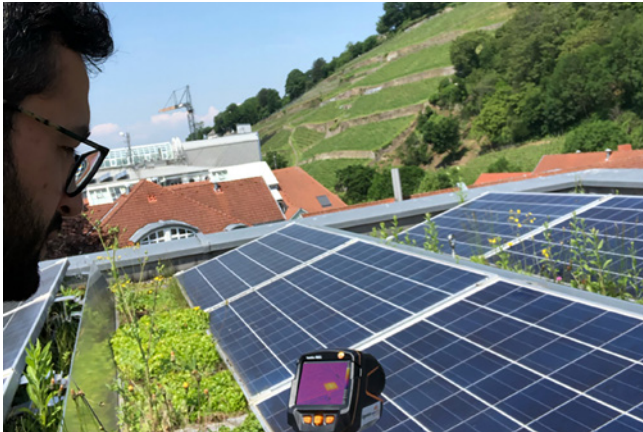
Figura 3: Uso de la cámara termográfica testo 883 para la inspección de la instalación fotovoltaica.
