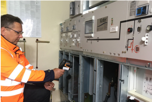
Abbildung 1: Thermografische Messung an einer Mittelspannungsschaltanlage.
