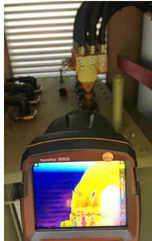
Abbildung 2: Thermografische Aufnahme der Anbindung eines Transformators (20.000 Volt auf 400 Volt) über Niederspannungskabel.
