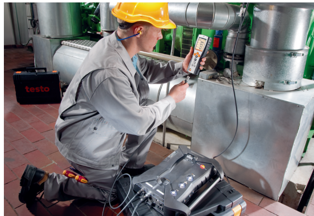
Preparazione di una misura su un impianto di cogenerazione con testo 350.
