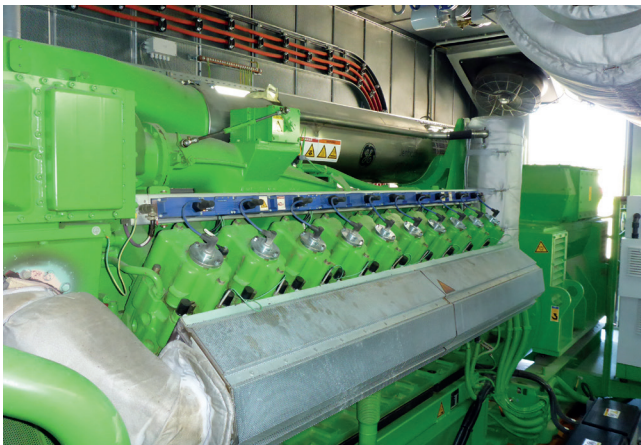
Un impianto di cogenerazione di 2G in funzione.
