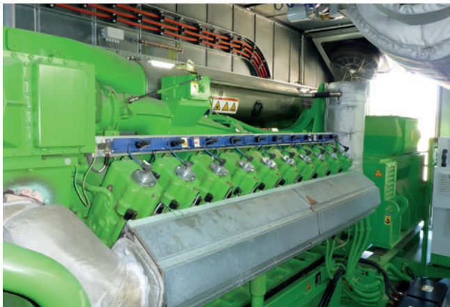
Una planta de cogeneración de 2G en funcionamiento.
