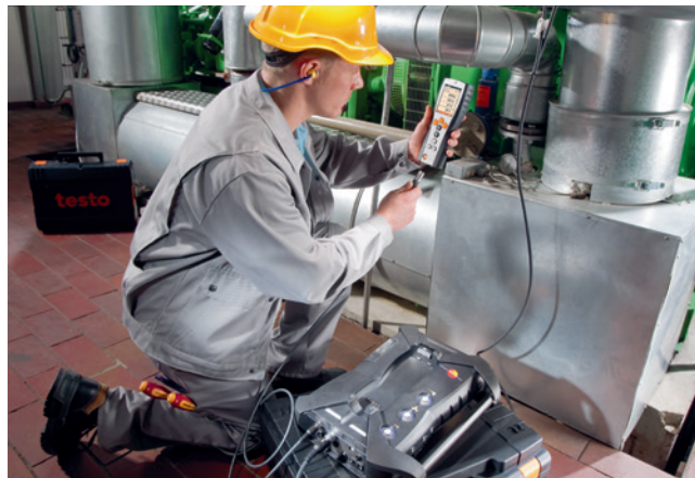
Preparación de una medición de control en una planta de cogeneración con el testo 350.
