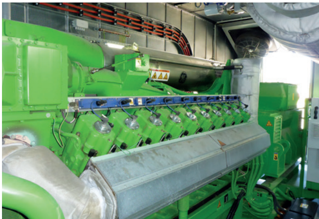
Ein in Betrieb befindliches Blockheizkraftwerk von 2G.
