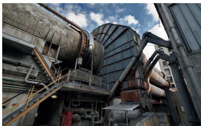
Quema de la harina cruda en la instalación de precalentamiento y en el horno tubular giratorio.
