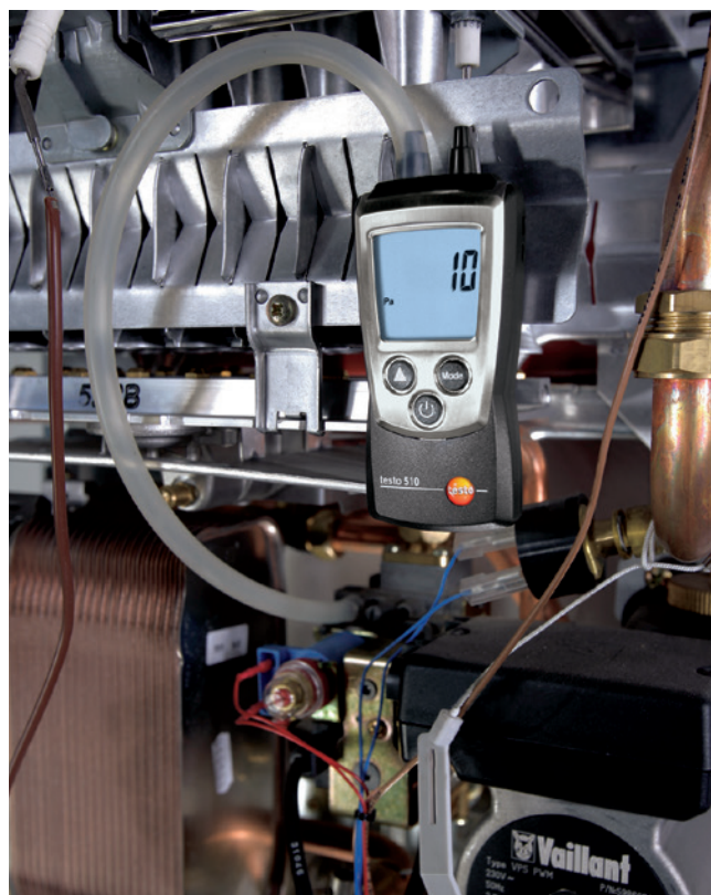
Lectura de la presión en la toma de gas y en la tobera en la testo 510
