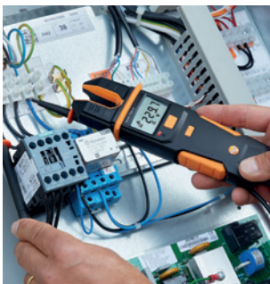
Spannungsmessung an einem Verdichter.
