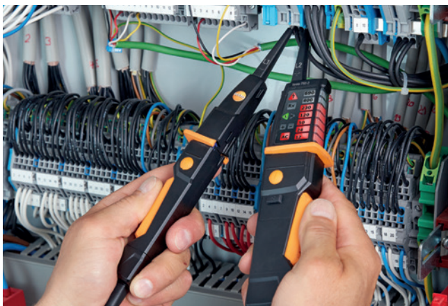
Spannungsmessung im Schaltschrank.
