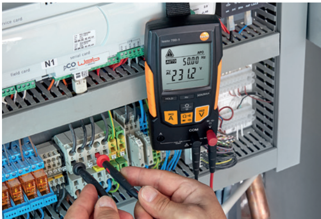
Spannungsprüfung am Schaltfeld einer Wärmepumpe.
