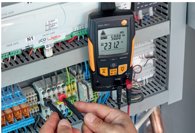
Spanning meten bij het schakelveld van een warmtepomp.
