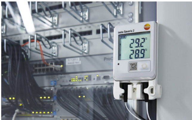
Ein System für alle Serverräume – auch in unterschiedlichen Gebäuden.
