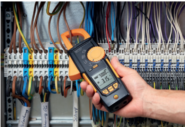
Strommessung am Schaltschrank.
