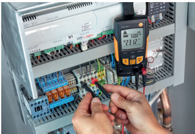
Spannungsprüfung am Schaltfeld einer Wärmepumpe.
