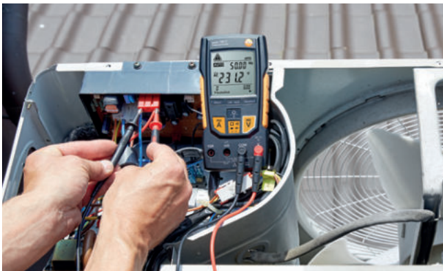
Spannungsmessung an einer Kälte-Außeneinheit mit testo 760 .
