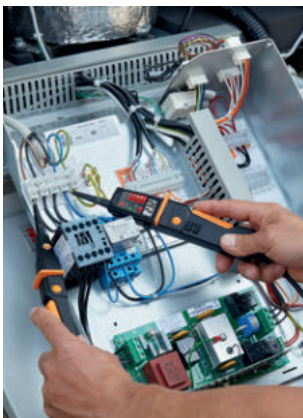
Spannungsmessung an einem Verdichter.
