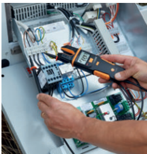
Spannungsmessung an einem Verdichter.
