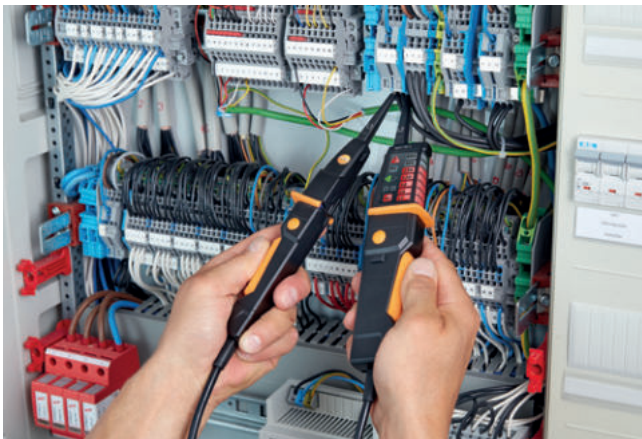
Spannungsmessung im Schaltschrank.
