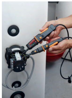
Spannungsmessung an einem Heizlastspeicher.
