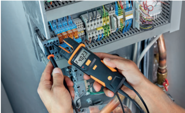
Spannungsprüfung an einer Wärmepumpe mit testo 755 .
