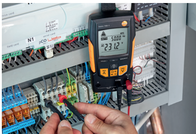
Contrôle de tension sur le tableau de commande d'une pompe à chaleur.
