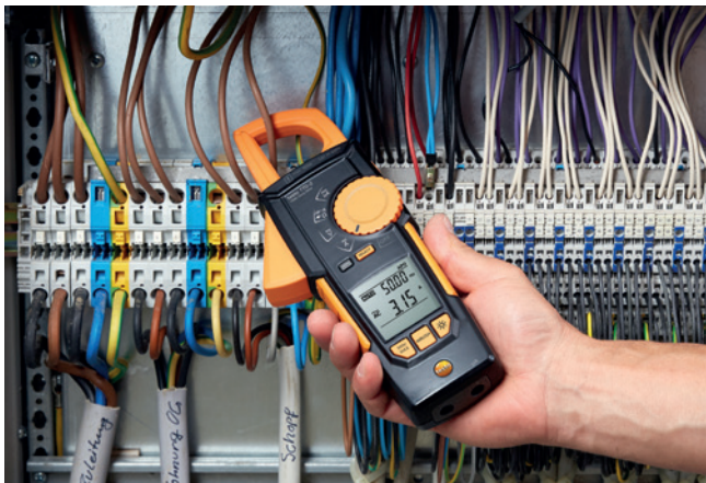
Mesure de courant sur une armoire électrique.
