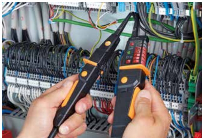
Pomiar napięcia w szafach sterowniczych.
