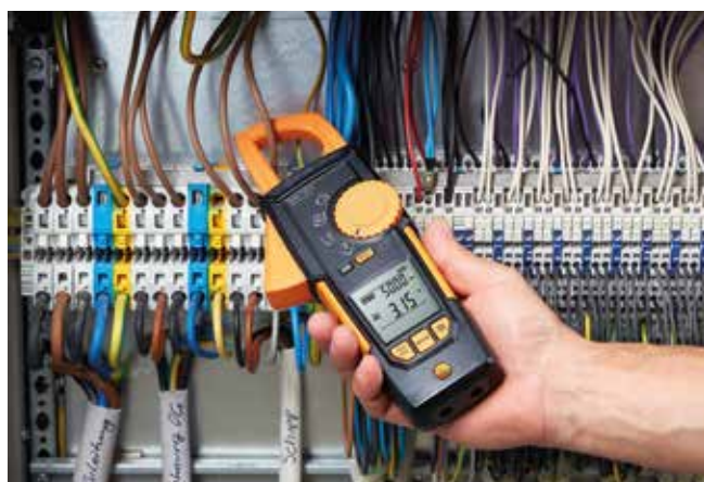
Pomiar prądu w szafach sterowniczych.
