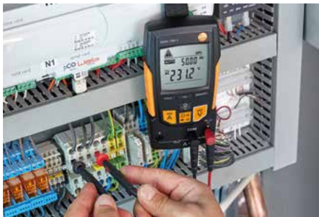
Kontrola napięcia w skrzynce elektrycznej pompy ciepła.
