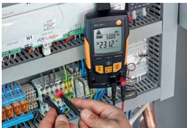
Kontrola napięcia w skrzynce elektrycznej pompy ciepła.
