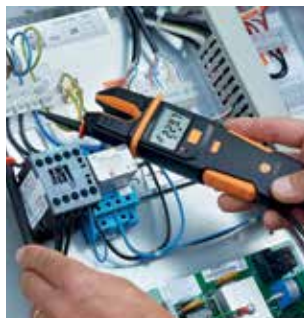
Pomiar napięcia na sprężarce.
