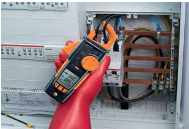
Pomiar prądu w szafach sterowniczych.
