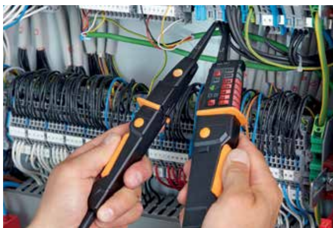
Pomiar napięcia w szafach sterowniczych.
