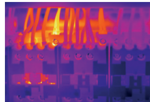
Konserwacja: identyfikacja przegrzania bezpieczników i innych komponentów elektrycznych
