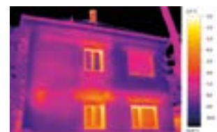
Warmtebeeld met testo ScaleAssist
