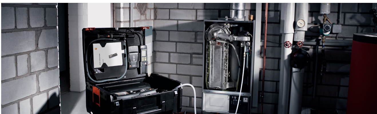
Aansluiting op gasboiler
