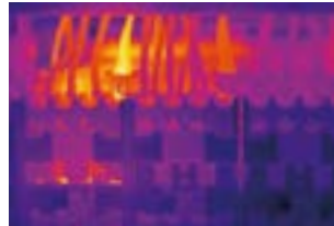
Installaties in stand houden: te hoge temperaturen bij zekeringen en elektrische componenten detecteren voordat installaties uitvallen.
