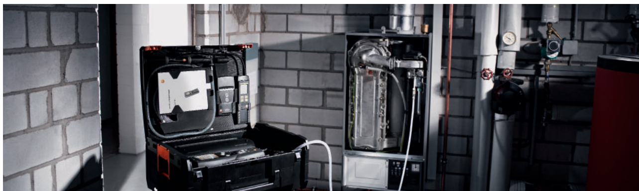
Controllo automatico della capacità operativa con serbatoio di riempimento gas collegato alla caldaia a gas
