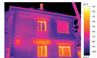
Wärmebild mit testo ScaleAssist
