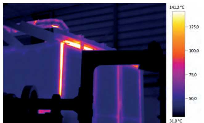
Horno industrial con fallo de aislamiento.
