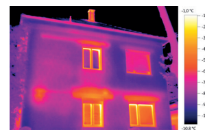
Imagen térmica con testo ScaleAssist
