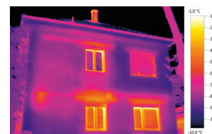
Wärmebild mit testo ScaleAssist
