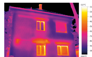
Wärmebild mit testo ScaleAssist
