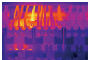
Údržba zařízení: rozeznání příliš vysokých teplot na pojistkách a elektrických součástkách dříve, než dojde k výpadkům.
